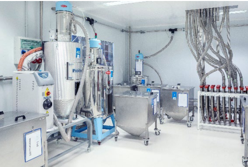
Sala de distribución de materia prima
